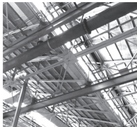
図 2 頭上の配管や通路
