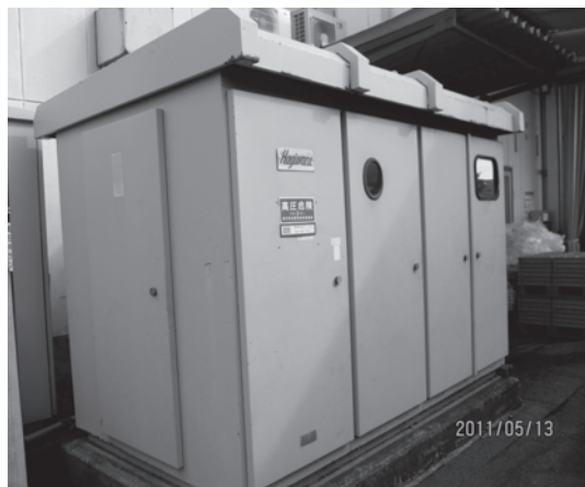
写真1 キュービクル
