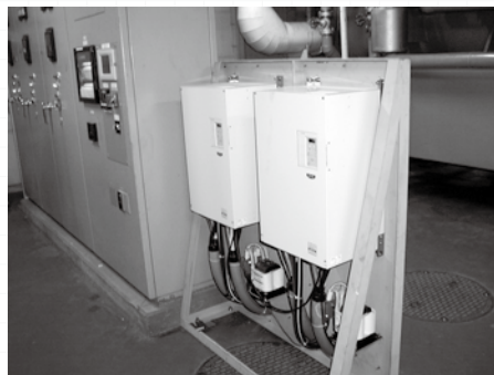
写真1 インバータ取付け写真
